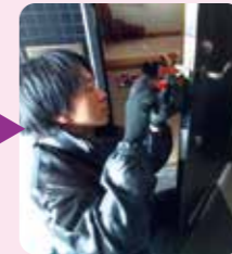
インターホンリニューアルと 同時に居室鍵交換も(西川)
